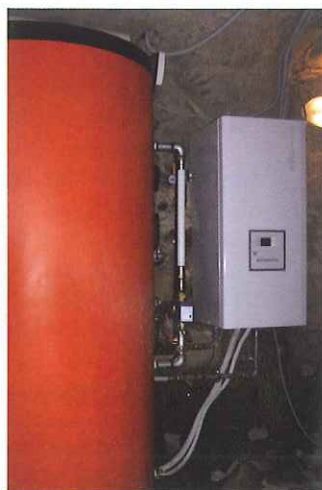
Unità idronica e puffer
